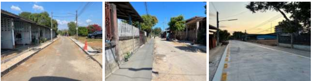
๓. โครงการก่อสร้างถนนพร้อมวางท่อระบายน้ำซอยจินดาวัฒน์ (ต่อจากของเดิม) (ชุมชนหนองกระโดง) (กันเงิน ๖๖) งบประมาณตามเทศบัญญัติ ๒,๘๓๒,๗๘๐ บาท งบประมาณที่เบิกจ่าย ๒,๘๓๒,๗๘๐ บาท กองช่าง
